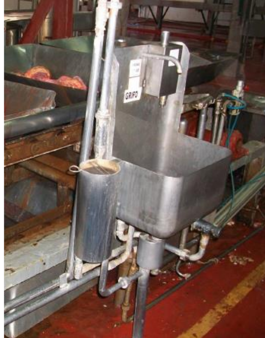
Esterilizador de cuchillo y lavamanos
